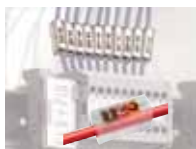
Провода и кабели
